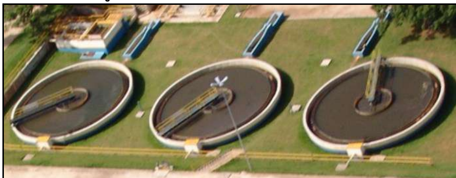
Figura 77 - Decantadores - ETE Jaguariúna.
