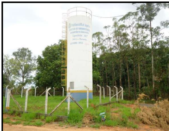
Figura 52 - Reservatório Floresta (80 m³).
