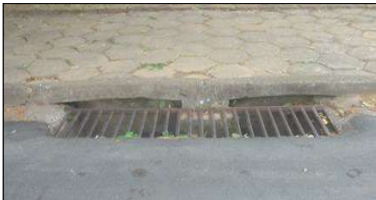
Figura 111 - Estrutura de microdrenagem de Jaguariúna.
