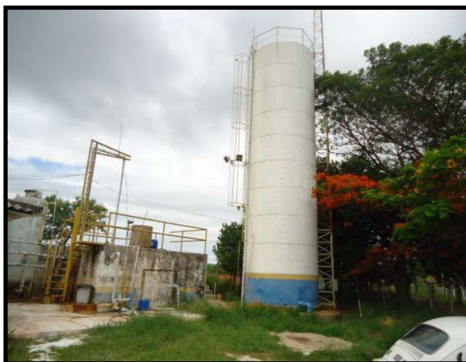
Figura 50 - Reservatório Elevado Ana Helena (100 m³).
