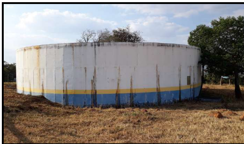
Figura 32 - Reservatório Capotuna II (1.200 m³) – novo implantado em 2018
