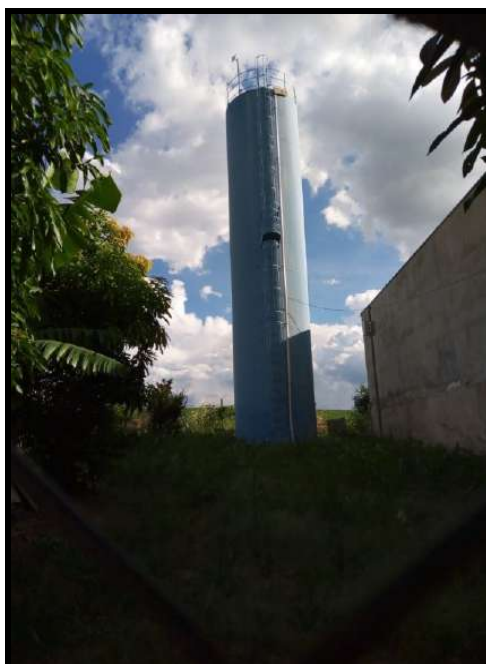
Figura 48 - Reservatório Reserva da Barra (200 m³).
