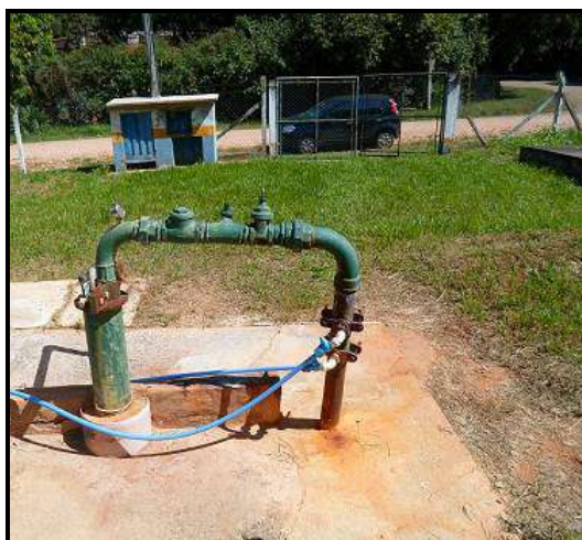
Figura 21 - Captação Poço Subterrâneo Santo Antônio do Jardim.
